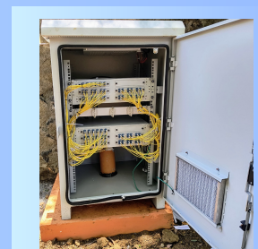
Optical Distribution Cabinet (ODC)
